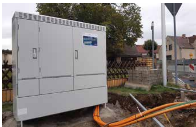
In zentraler Ortslage von Treugeböhla wurde nun das Multifunktionsgehäuse (MFG) aufgestellt. Von dort werden die Anwohner an das Glasfasernetz angeschlossen. | Foto: ENSO NETZ, von Neuhoff.
